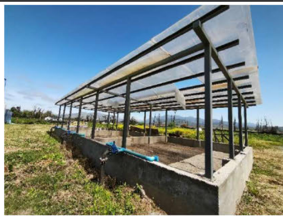
4. Canchas de secado en desuso
