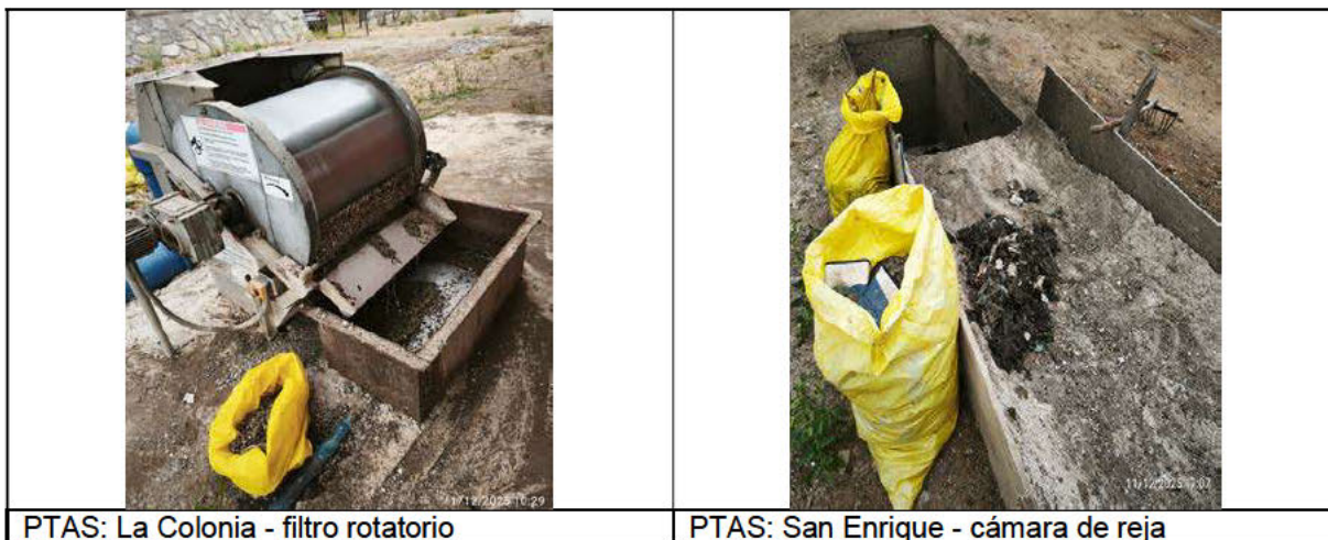
Imagen N° 6: Fotografías de acumulación de residuos sólidos en cámara de reja y filtro rotatorio.
