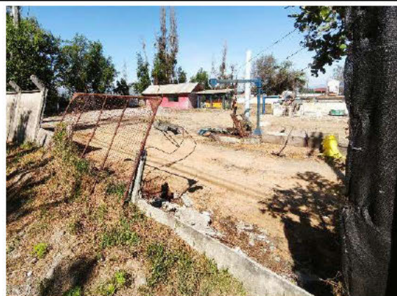
4. Ausencia de cierre perimetral
