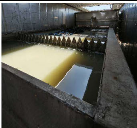
3. Container para tratamiento de lodos
