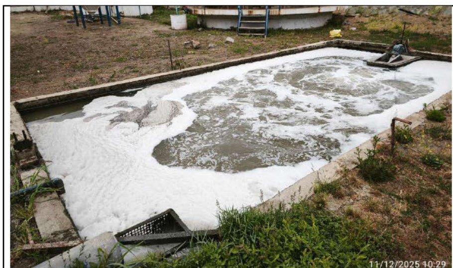
Imagen N° 7: Aireación excesiva que genera una gran cantidad de espuma y deficiente sedimentación.
