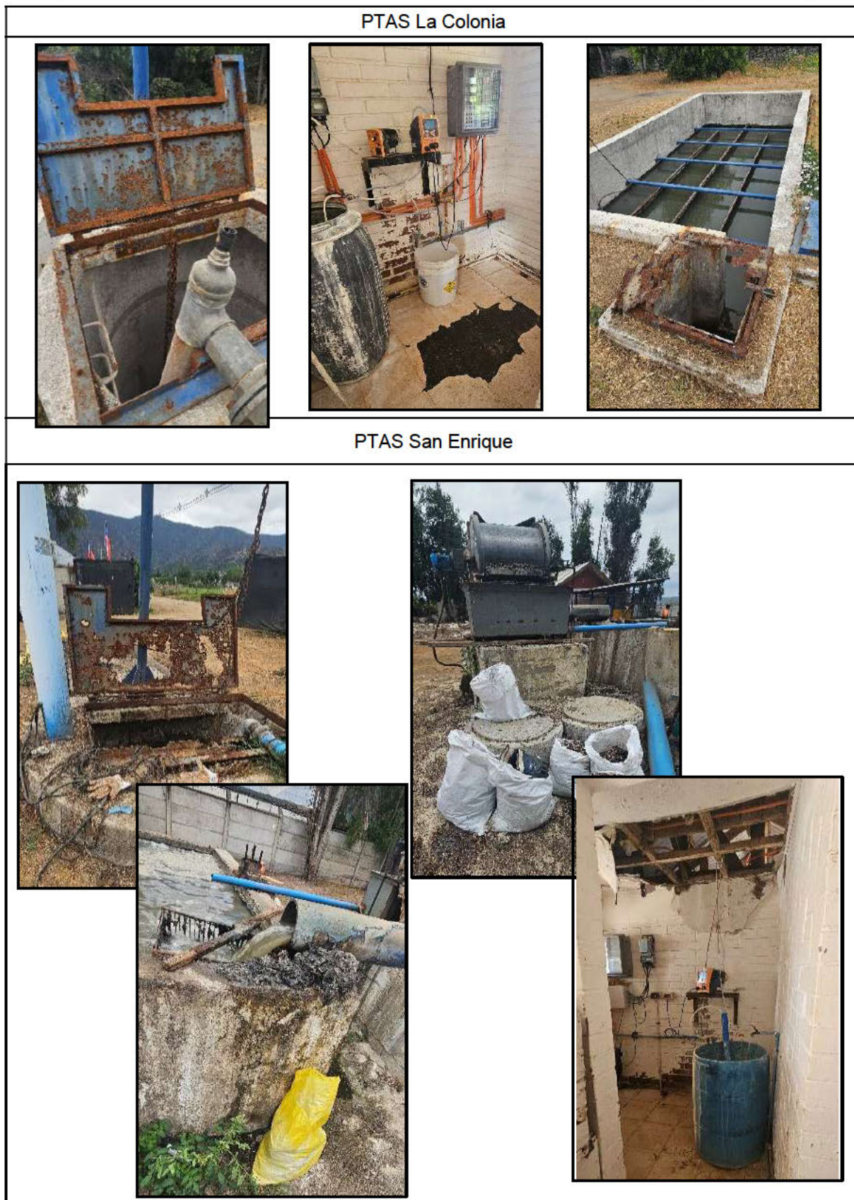
Imagen N° 12: Deficiencias de infraestructura en PTAS La Colonia y San Enrique.
