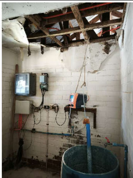
Fotografía N° 9: Sala de cloración.
