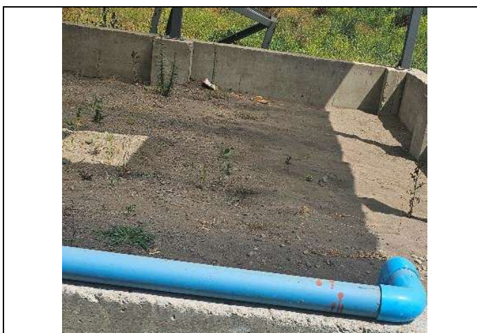
Imagen N° 10: Disposición de los lodos en las canchas de secado en las PTAS Chorombo Bajo.
